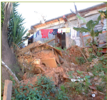
Moradia precária em encosta com risco de desabamento.
